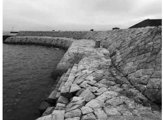
■西防波堤 (三代目工楽松右衛門による築造、その後改修されたものと推定)
